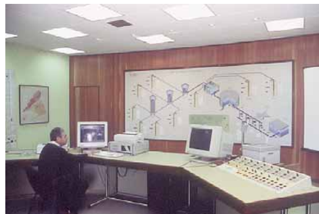
Fig. 4. La gestión de las aguas subterráneas necesita incorporar más intensamente criterios de uso racional y sostenible de los recursos. (Centro de control del campo de pozos de Fuencarral. Canal de Isabel II).
